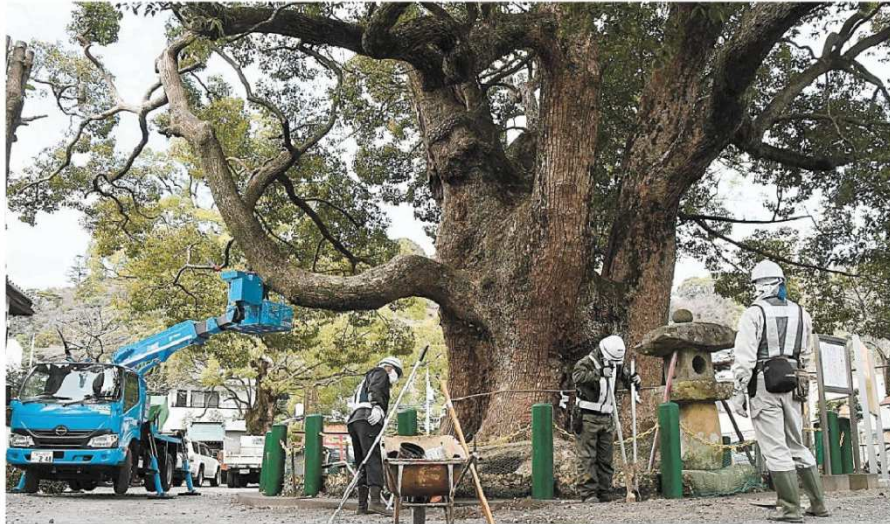
巨大なクスノキの周辺で行われる土壌改良の工事＝静岡市葵区の若宮八幡宮
