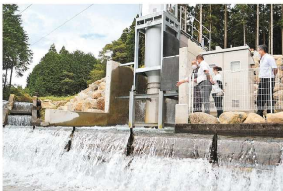
養鱒場内に完成した小水力発電所＝富士宮市原
