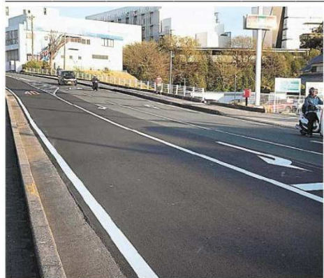
花王が開発したアスファルト改質剤を改修で採用した市道（手前側）＝22日午後、磐田市新貝
